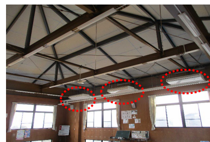
天井吊型空調機
