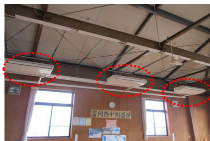
天井吊型空調機
